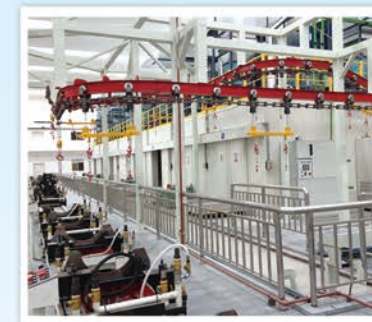
自动传送链 Automatic conveyor chain
